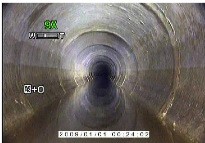
（中央控制工业管道内窥摄像）
