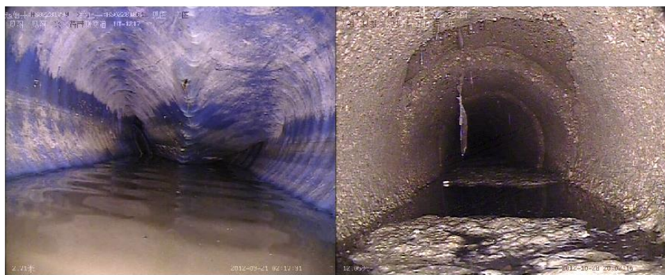
PVC波纹管承压力不够
