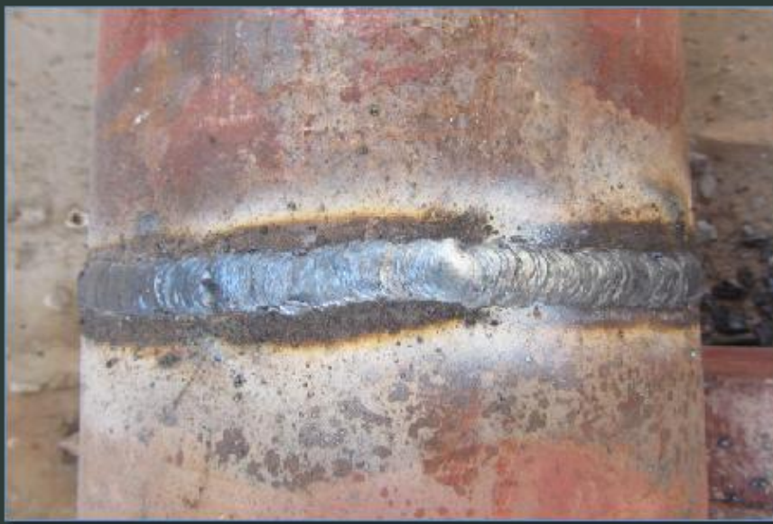
焊缝宽度不一致
