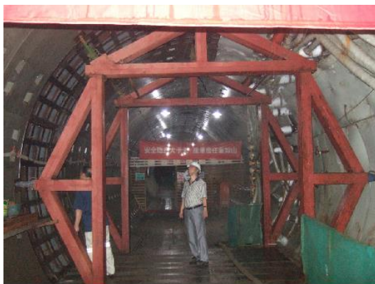
隧道预应力支架
