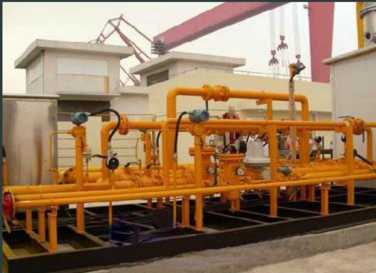
气源点—高压调压站
