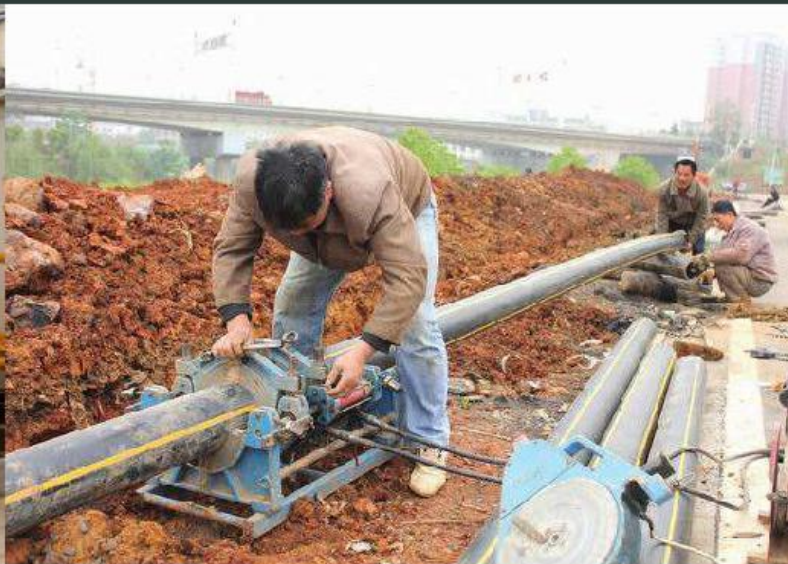
调压站—小区院落
