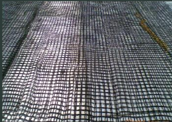
路面裂缝防治
