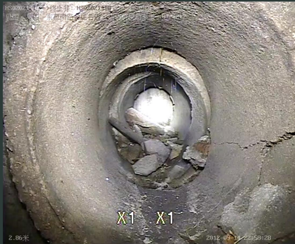
管道错口垃圾
