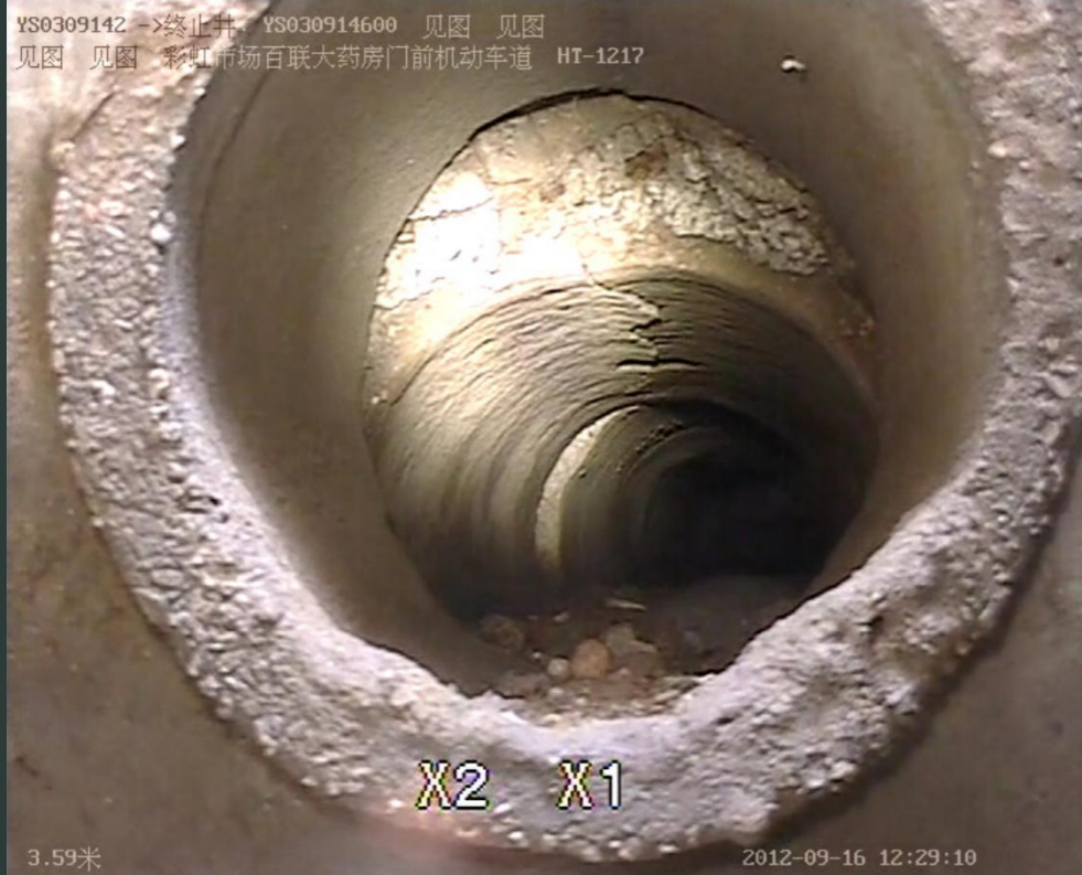
管道上部塌陷
