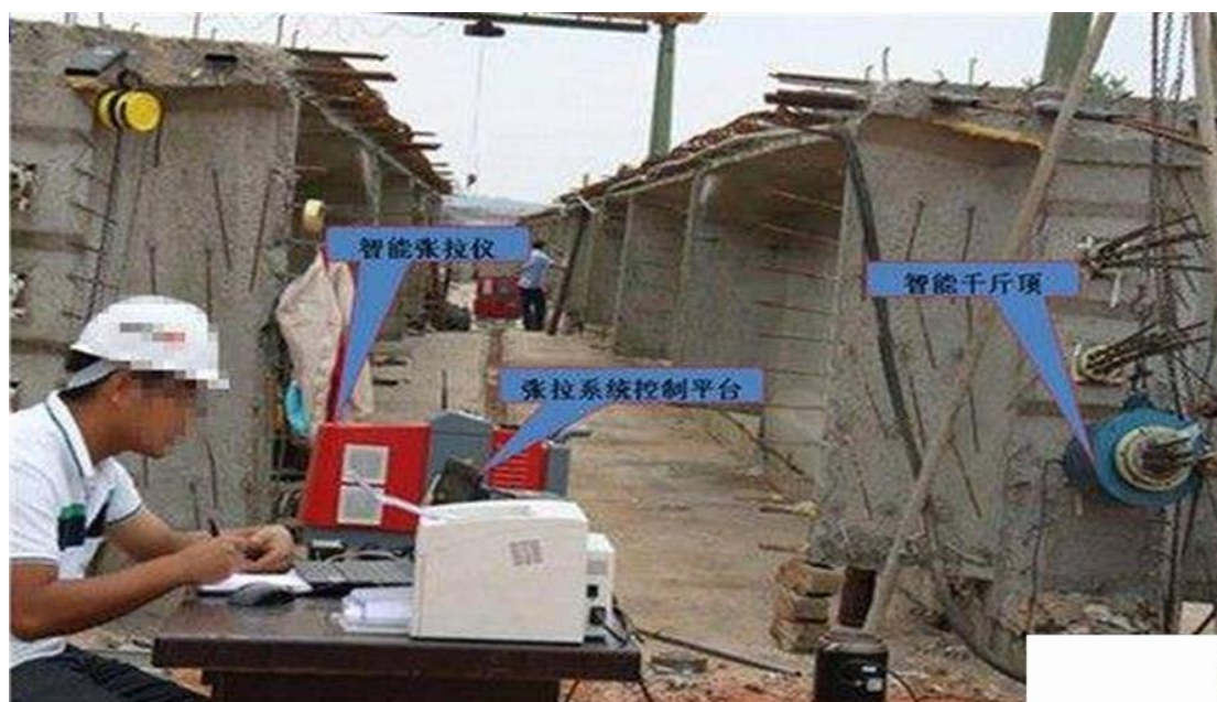
预应力施工质量智能控制系统
